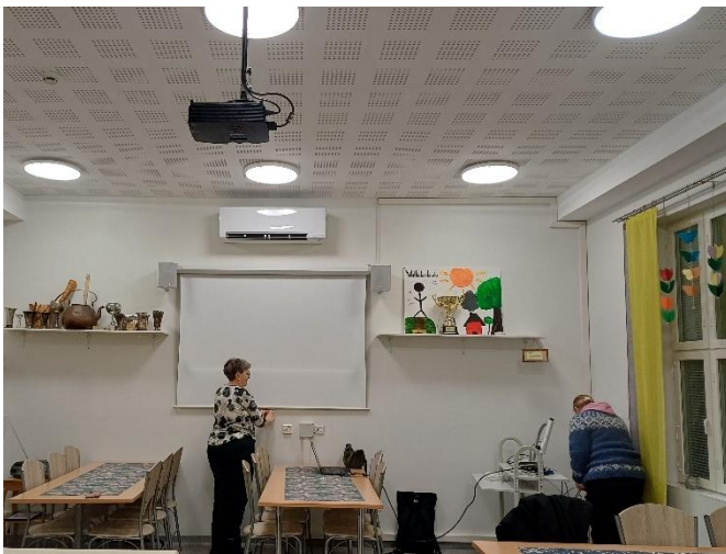
3 Ilmalämpöpumppu kylätuvassa. Kuva: Jyväsihi ry
